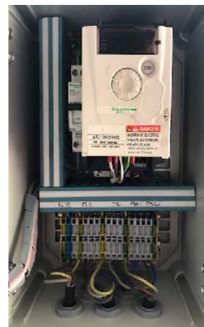
Coffret électrique avec variateur
